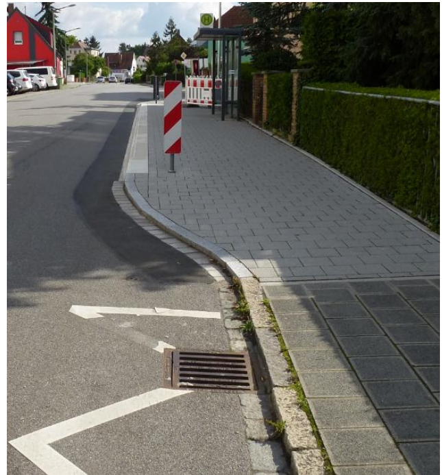
Abb. 7: Die Haltestelle Stein Sommerstraße im Landkreis Fürth wurde von einer nicht barrierefreien Haltestelle am Fahrbahnrand zu einer vollständig barrierefreien Kaphaltestelle umgebaut. Die Gehwegbreite wurde dazu auf einer Länge von rund 15 Meter von 1,90 m auf 2,80 m vergrößert. Die Warte- und Rangierfläche ist nun ausreichend breit und das Hochbord kann parallel und spaltminimierend angefahren werden. In beiden Fahrtrichtungen ist das Kap durch Leitbaken abgesichert. Im Straßenverlauf befinden sich vor der Haltestelle Längsparkstreifen.
