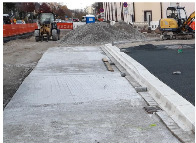
Abb. 19: Haltestelle Wiesenstraße, Fürth Entstehung einer festen, verformungsfreien Fahrspur durch den Einbau von Betonplatten im Haltestellenbereich im Zuge des barrierefreien Umbaus; anschließend wird die Asphaltenschicht aufgetragen.
